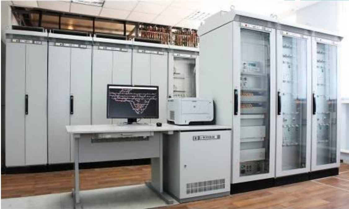
МПЦ-У на станции (релейное помещение)
